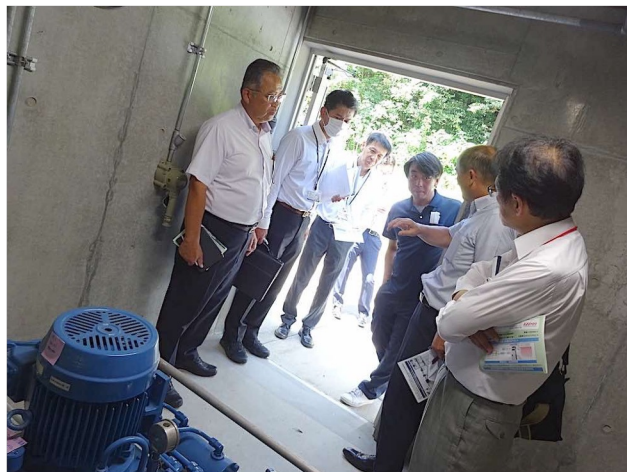
水素圧縮機の設置室にて撮影
