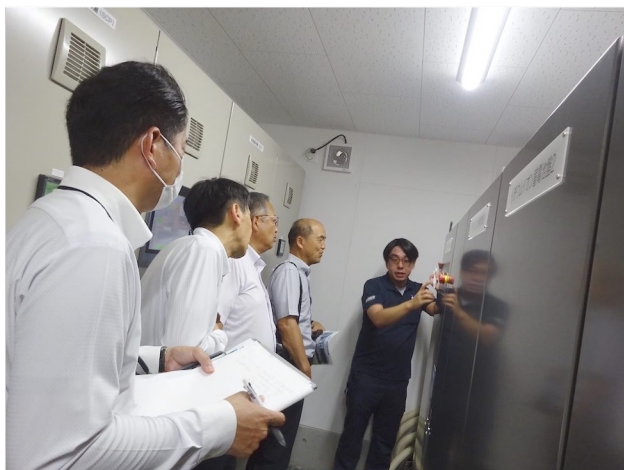
電気系制御室にて説明受け様子撮影
