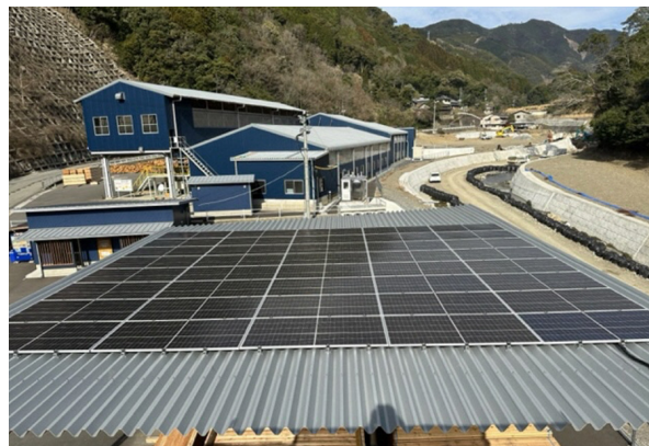
球磨村森林組合木質バイオマス施設に設置した太陽光パネル
